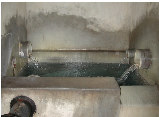
Mbledhja e ujit nga burimi në Bavari Ujëmbledhësi i burimit mund të realizohet me disa tuba të drenazhimit. Baseni duhet të jetë i mbuluar dhe i qëndrueshëm në fermentim.
