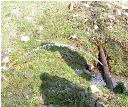
Korrozioni mund të shkaktojë rrjedhje serioze në sistemet shpërndarëse
